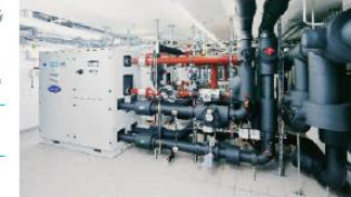
Perfektes Zusammenspiel: In lediglich sechs Wochen war die alte Anlage demontiert, die neue installiert
