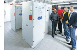
Zufrieden mit den beiden parallel geschalteten Flüssigkälteklümen: v.l. Karlheinz Frick (VP Bank), Fritz Schlegel, Christoph Gesson (Doppel Haus Technik) und Nicolas Scherrer (Frick AG)
